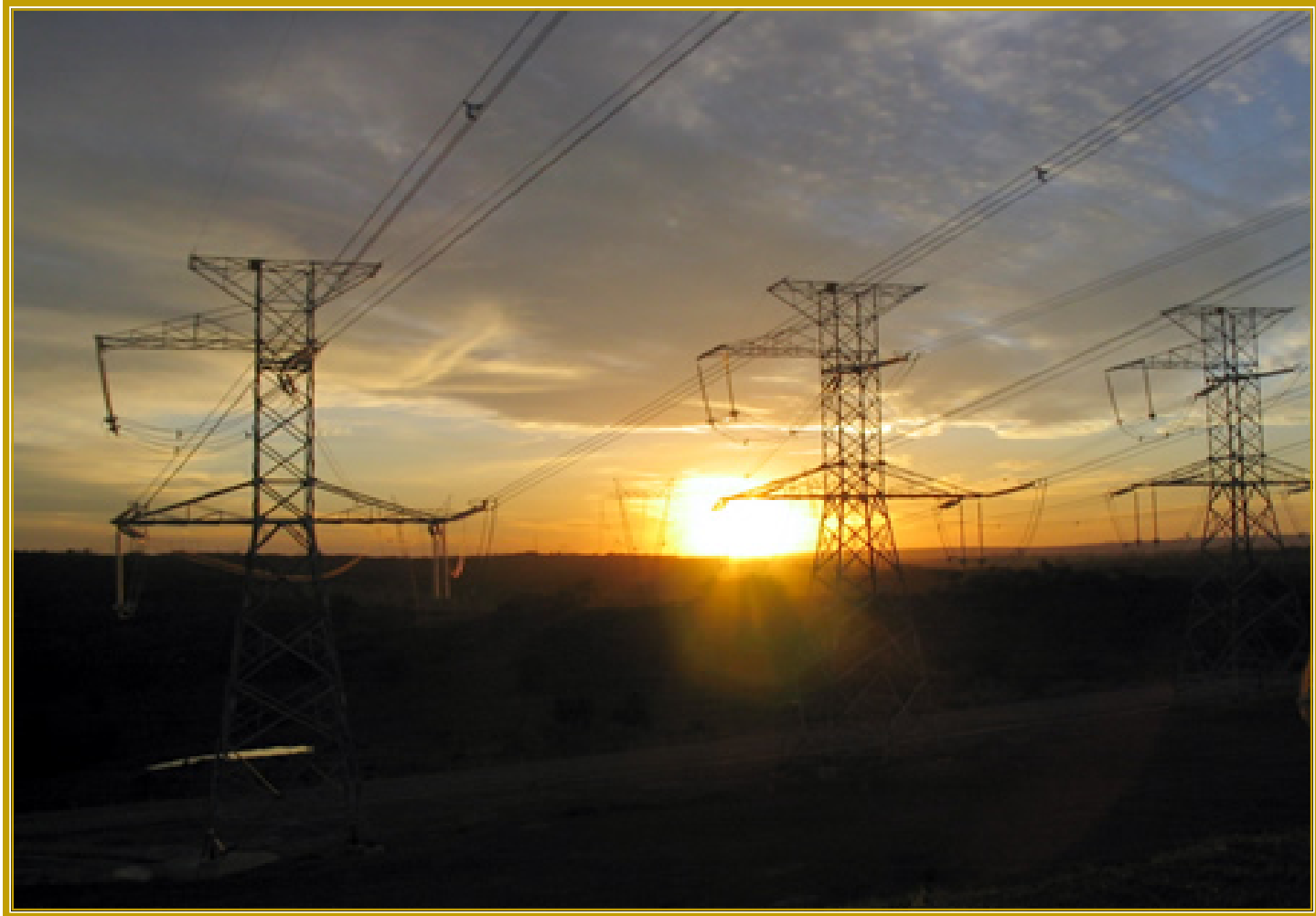
Foto da Subestação Bom Despacho saídas para Jaguará e São Gotardo
