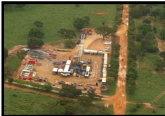
SF-T-104 – Poço Alegria
