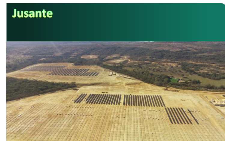
UFV Três Marias Jusante 70 MWp
