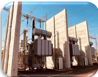
SE São Simão New Reactor 500kV
