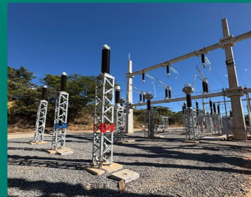
SE Montes Claros 2 – nova seção de 138kV
