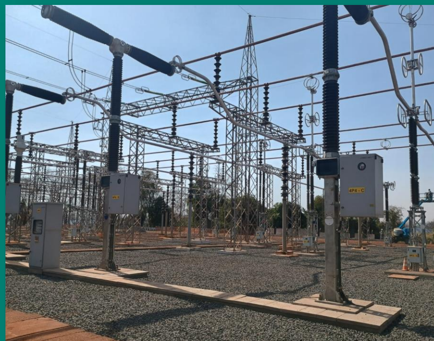
SE Volta Grande – novos equipamentos
