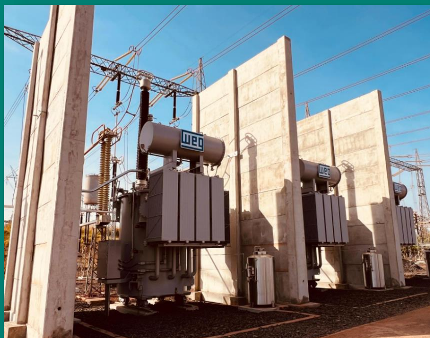
SE São Simão – novo reator 500kV
