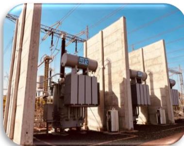
SE São Simão Novo Reator 500kV
