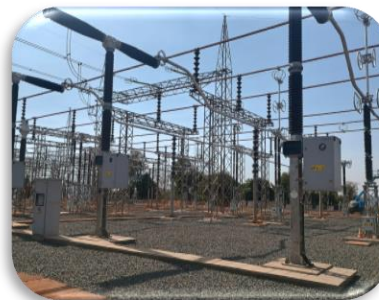
SE Volta Grande Novos equipamentos
