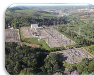
SE Lafaiete Novos equipamentos
